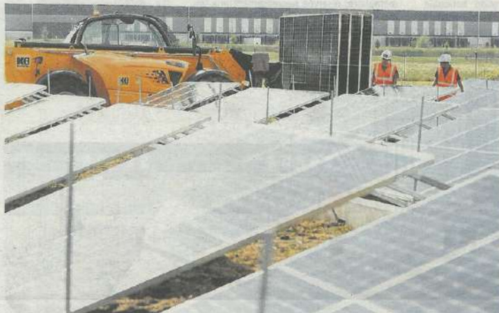
Les panneaux sont actuellement en cours d'installation chez Antoine. PHOTOS MATHIEU BOUTE
