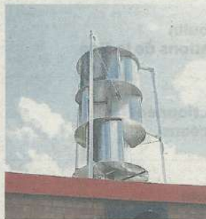
Les éoliennes urbaines d'Unéole (groupe né à Arras) ont le vent en poupe, en ce moment !
